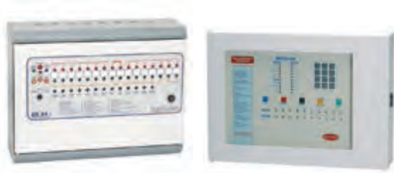
شکل ۲۵-۱ تابلوهای کنترل مرکزی از نوع متعارف
